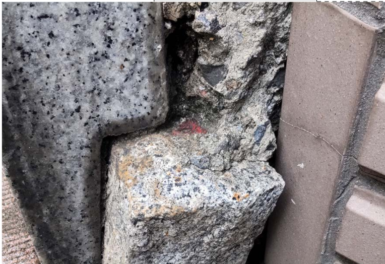
擁壁の基礎の抱かれた御影石 (擁壁の基礎に砂利が混じっている)
